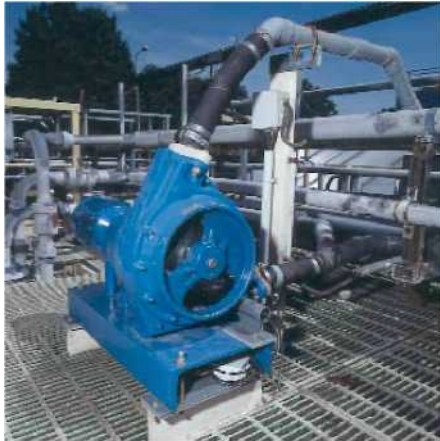
Насос Z в процессе работы (очистка сточных вод)
