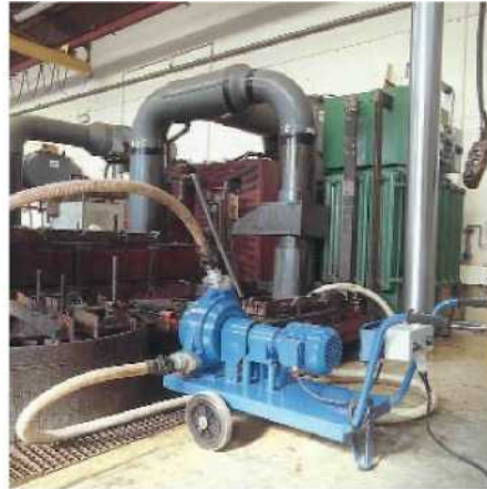
Насос Z дренаж скважины
