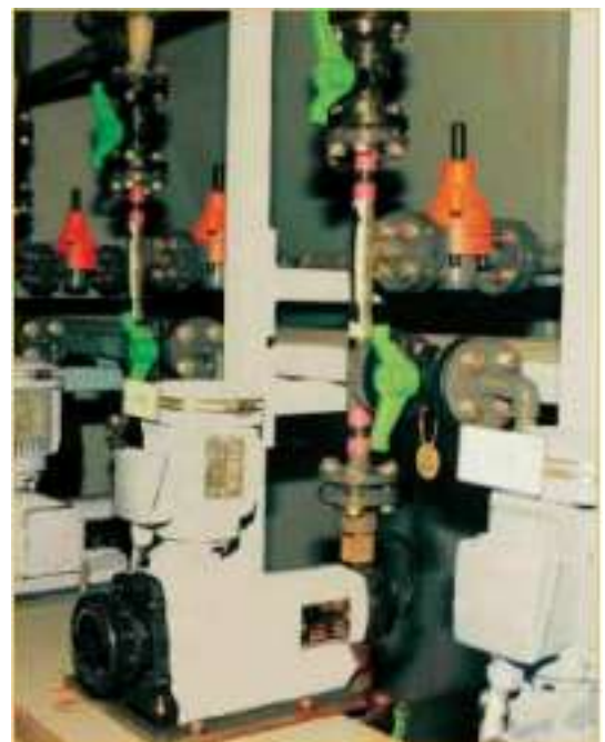
Перекачивание хлорида железа на станции очистки воды
