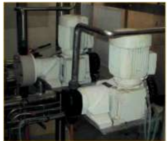
Дозирование кислоты и щелочи
